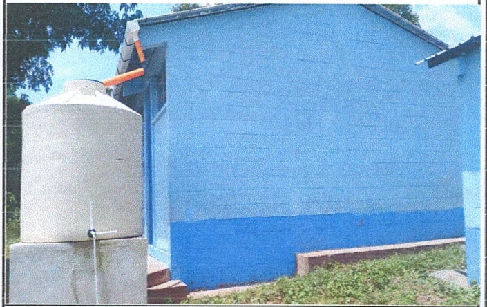
Foto 4: ESTADO ACTUAL DEL TINACO
